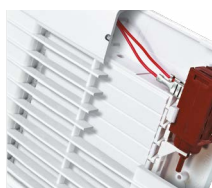
Wentylator nie pracuje – żaluzja jest zamknięta
